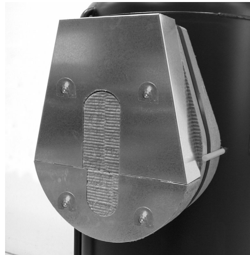
Isolation avant de la bride installée
